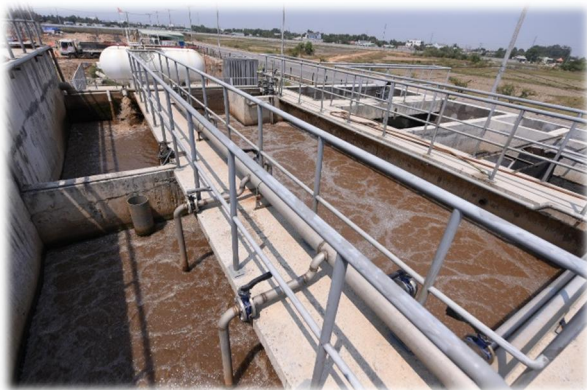
Hệ thống xử lý nước thải tại nhà máy bánh kẹo
