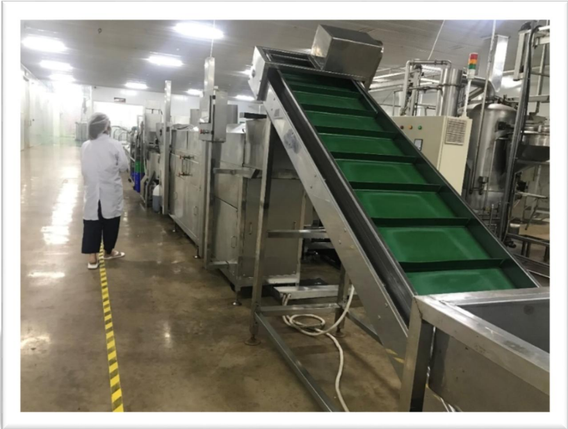
Dây chuyền chuyền tự động mới được lắp đặt của Lafooco giúp kiểm soát thông số tự động, nâng cao mức độ an toàn thực phẩm.
